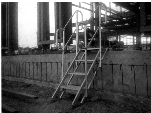
倉庫荷捌場より昇降の為の設備
