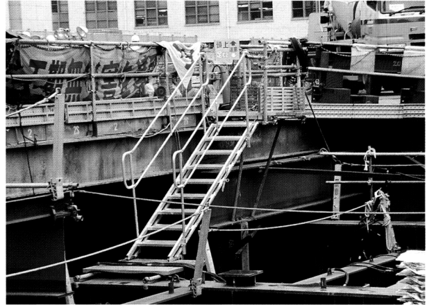
乗入構台より梁上に降りる為の昇降設備
